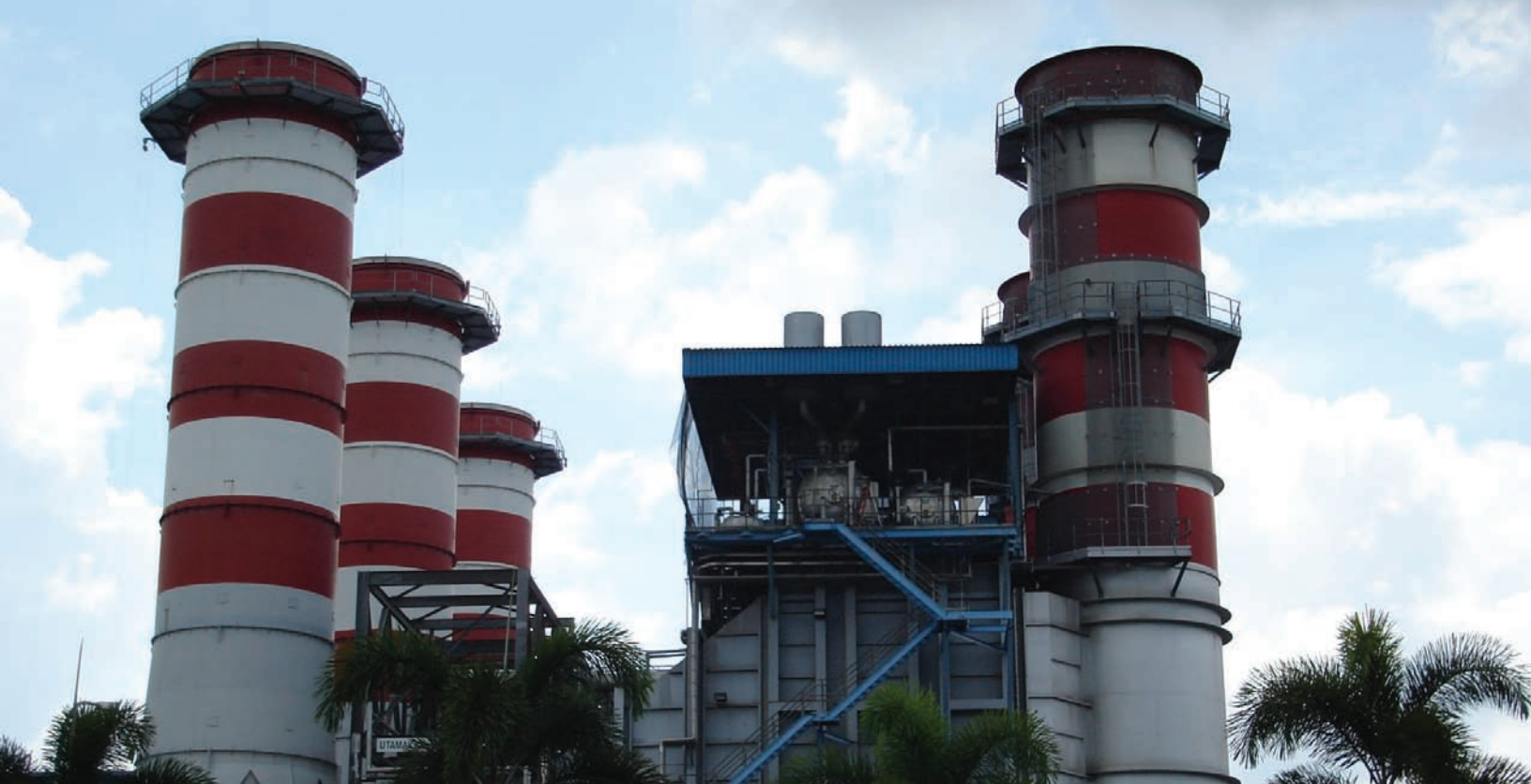
Cogénération dans une usine de production d'huile de palme (Malaisie)
